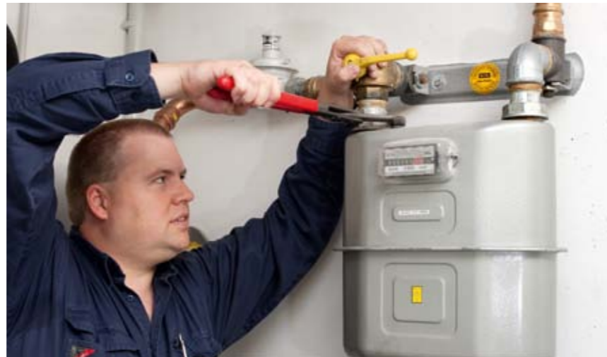
Die Dichtheitsprüfung sollte alle vier Jahre vom Fachmann durchgeführt werden.
